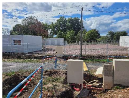
Etat des branchements électriques le 30/08
